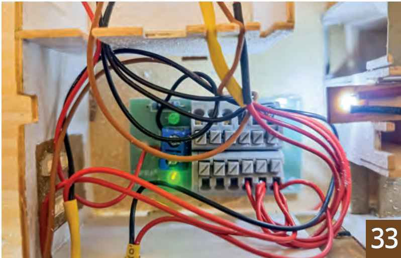
Sechsfach-Stromverteiler mit grüner Kontrollleuchte
