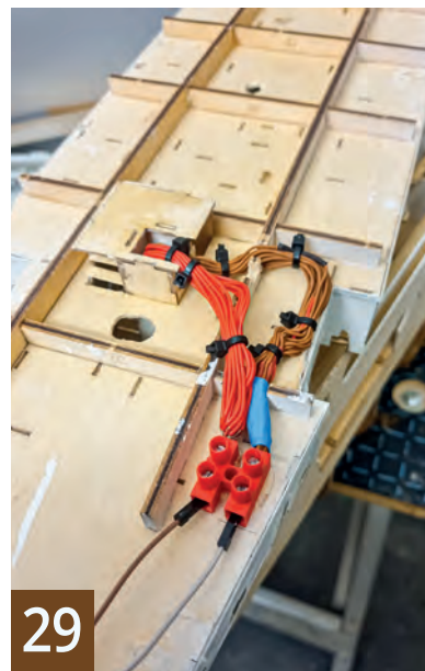
29 Saubere Kabelführung mit Lüsterklemme unter Deck
